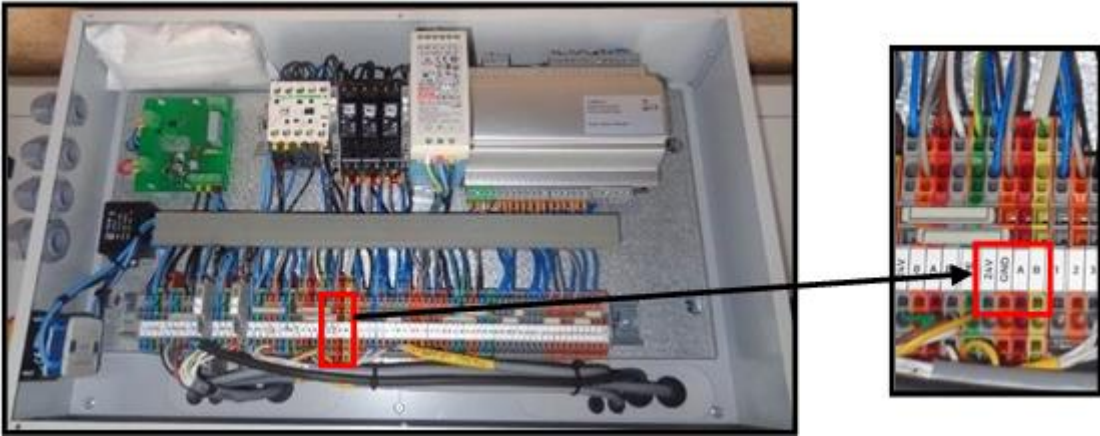
Şekil 16. HMI kablosunun elektrik panosu içerisindeki terminal bağlantı yerinin gösterimi.
